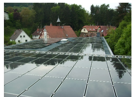
Solarstromanlage in Bensheim-Zell
